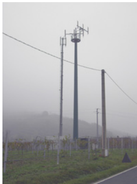
Impianti Wind e Vodafone
