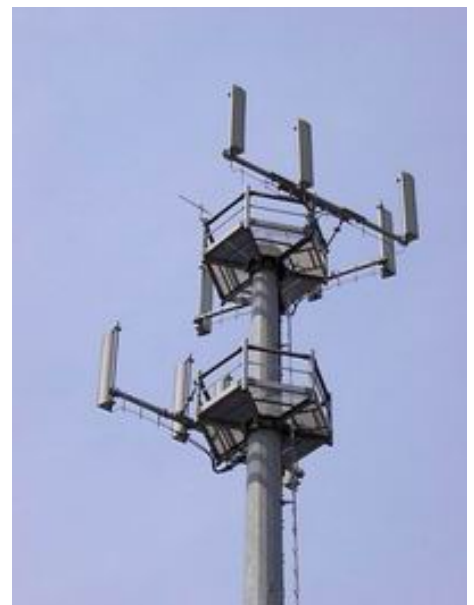
Impianto Telecom Italia
