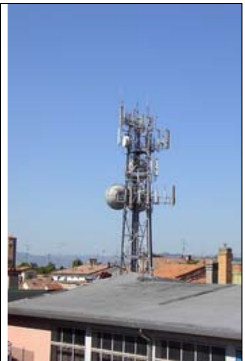
Impianto TIM / Vodafone / Wind / H3G
