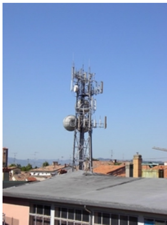
Impianto TIM / Vodafone / Wind / H3G
