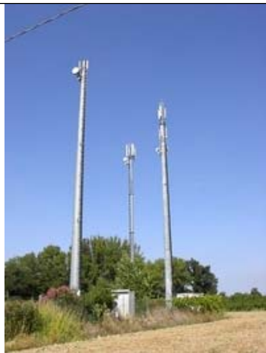
Impianto H3G / Vodafone / Wind
