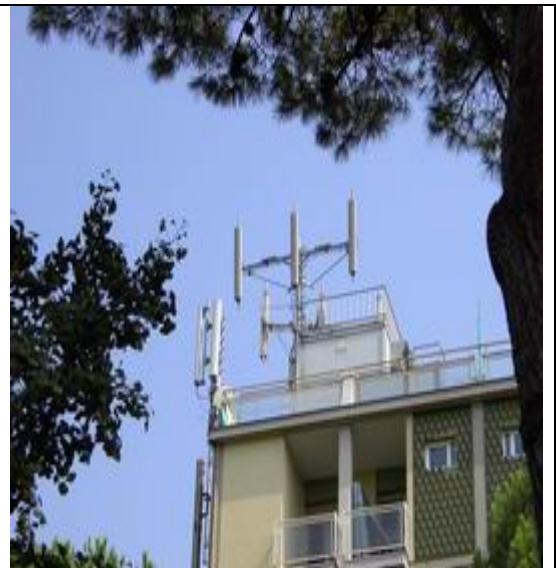
Impianto Vodafone / Wind
