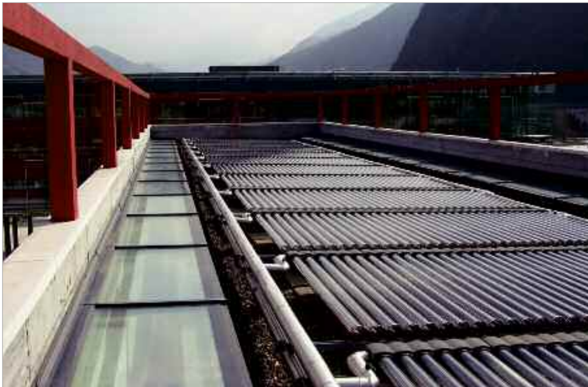
Impianto solare termico
