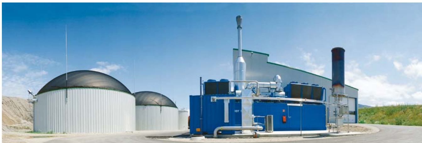
FOTO: SCHWICK BIOGAS
