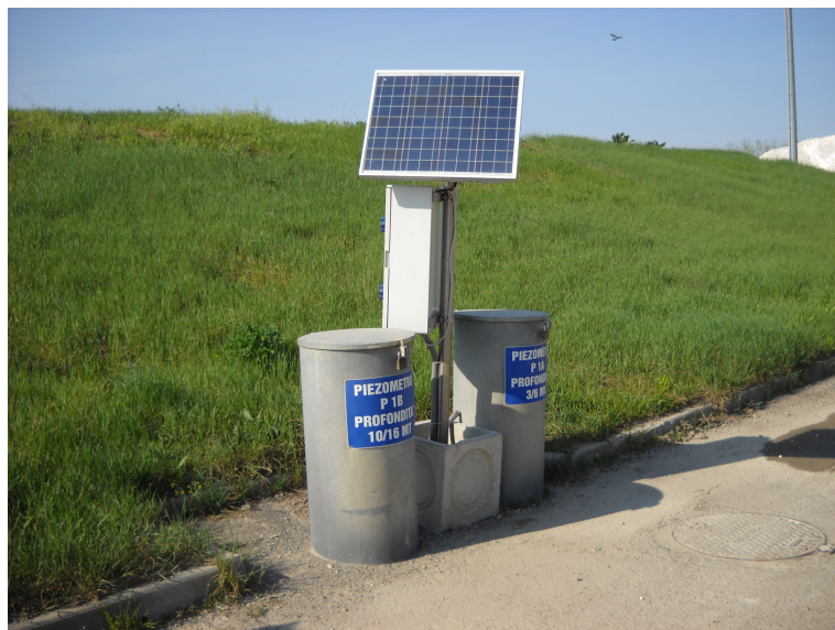
Vista dei piezometri P1A e P1B con dettaglio strumentazione per la rilevazione in continuo di conducibilità e pH per il pozzo P1A
