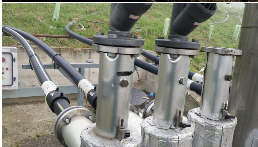
Particolare di un pozzo per l'estrazione del biogas e di una sottostazione per la regolazione del biogas
