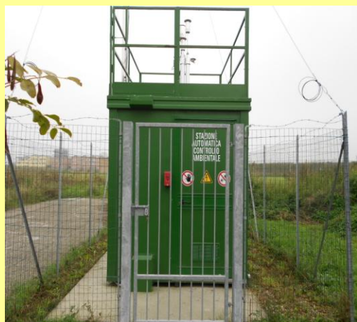
Stazione: Porto S. Vitale (Ravenna) ex SAPIR
