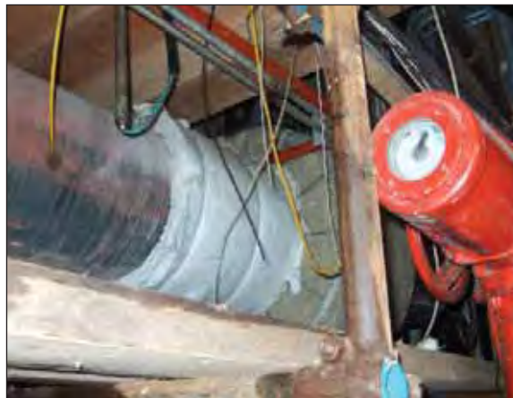
Foto 12 - Vari strati di coibente sulla tubazione
