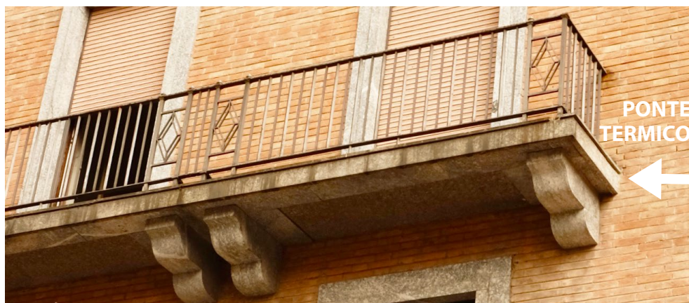
Figura 5: Esempio di ponte termico (balcone)
