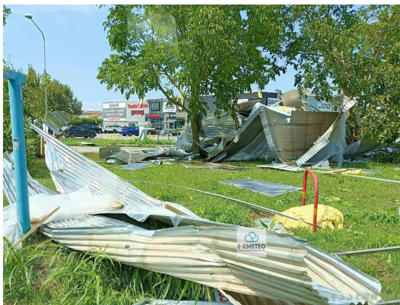
Figura 37 Danni a strutture, autovetture e alberature a Vigarano Mainarda (FE) a seguito del temporale del 21 luglio 2026. Fonte: pagina Facebook Emilia Romagna Meteo; fotografie di Alessandro Bruni.
