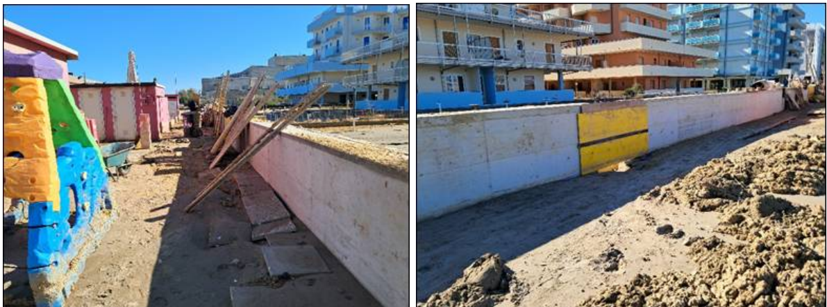
Figura 21: dettaglio danni agli stabilimenti balneari a Valverde (zona Bagno Schiuma - Fonte: AGSS).
