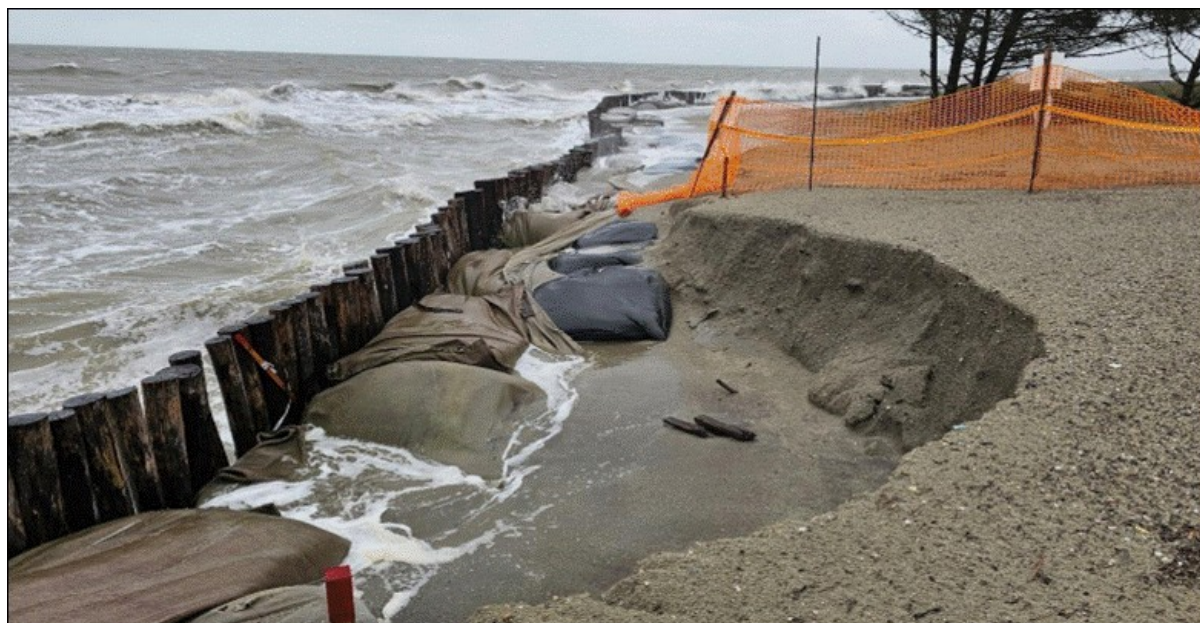
Figura 11: Bagno Isa/primo pennello: forte erosione e ammaloramento dell'opera di difesa (Fonte: ARSTPC-UT FE).
